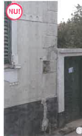
ASA NU: Se interzice montarea contoarelor electrice pe fațada de la stradă, acest lucru riscând să deterioreze decorațiile sau alte inscripții încă nedecapate și urâțind în același timp fațada. Se recomandă montarea lor în interiorul incintei, legislația prevăzând că acestea trebuie montate în locuri ușor accesibile și nu neapărat pe fațada de la stradă, așa cum se întâmplă adesea.
