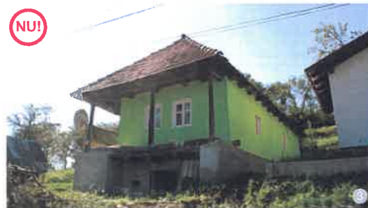
ASA NU: Zugrăvelile moderne sunt incompatibile cu materialele de construcție tradiționale (lemn, piatră, cărămidă), deoarece împiedică transferul de vapori de apă dinspre interior spre exterior. Acest lucru va duce, în timp, la deteriorarea peretelui și a finisajului exterior.
