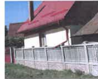
ASA NU: Se va evita direcționarea apelor pluviale de pe acoperiș către șanțul exterior gospodăriei.
