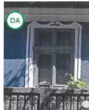
AȘA DA: Se recomandă repararea ferestrelor originare și nu înlocuirea lor cu altele noi, cu tâmplăria de PVC, cele din lemn fiind mult mai frumoase și adaptate la nevoile construcțiilor vechi. Montarea de tâmplărie PVC poate duce la apariția igrasiei.
