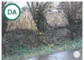
ASA DA: Împrejmuirea din nuiele are ca suport arborii de pe limita de proprietate.
