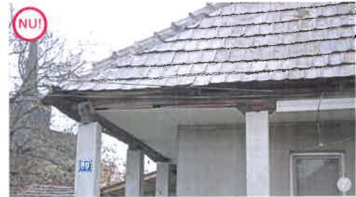
ASA NU: Nu se recomandă folosirea placărilor cu plastic sau a plăcilor de gips-carton peste elementele de lemn ale târnațului, ale obloanelor, ale stâlpilor, ale streșinii, ale paziei, ale capetelor de grinzi. Nefiind necesare, nu fac decât să altereze imaginea casei tradiționale.
