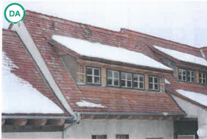
AȘA DA: Amenajarea unor lucrări de lungimi mai mari permite iluminarea și ventilarea mai eficientă a spațiilor locuibile amenajate în mansardă, precum și o atmosferă mai plăcută în interior.
