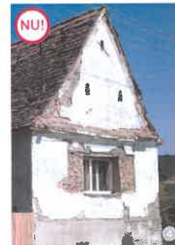
ASA NU: Caz frecvent de modificare inadecvată a golurilor ferestrelor de la fațadă: prin amenajarea unui gol în axa frontonului, se slăbește stabilitatea acestuia, riscând să apară fisuri.
