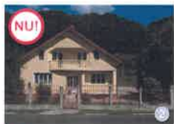
ASA NU: Proporția ferestrelor este de bloc comunist și nu respectă specificul local; împărțirea canaturilor este impersonală, iar ritmul gurilor nu are nicio legătură cu specificul local.
