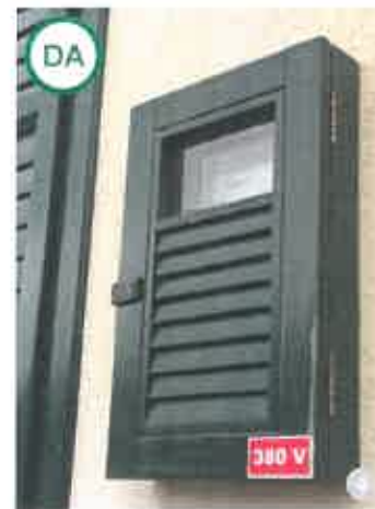
ASA DA: Mod de mascare și de protecție a unui contor electric.
